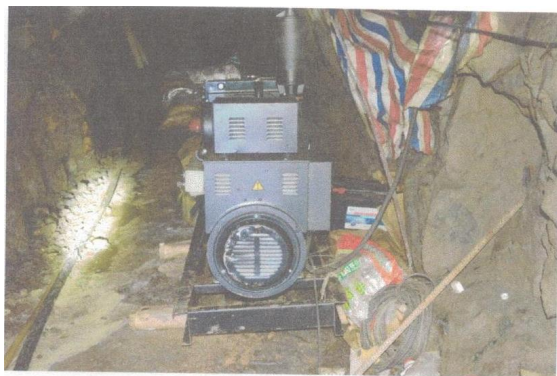
图 4 洞内约 50 米处的发电机等
